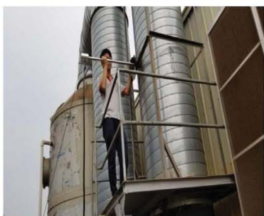
图17: FQ5-17502 焊接废气排放口 (处理后)
