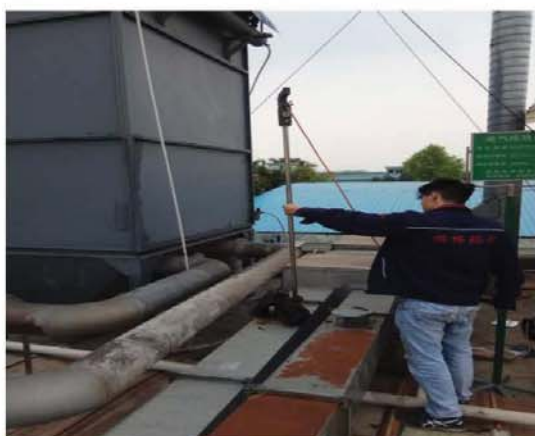
图9: FQ4-17052 热固化废气采样口2 (处理前2)
