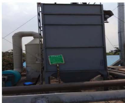
图32: 炉窑废气处理装置
