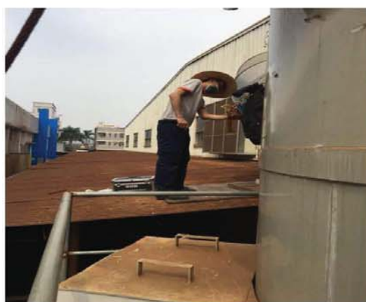
图16: FQ5-17502 焊接废气采样口 (处理前)
