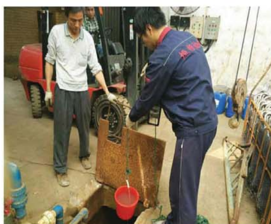
图18: 生产废水集水池 (处理前)
