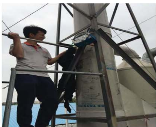
图15: FQ3-17502 酸洗废气采样口 (处理后)
