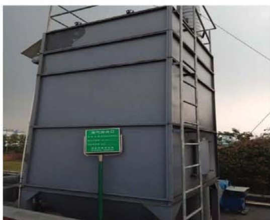
图31: 喷粉废气处理装置
