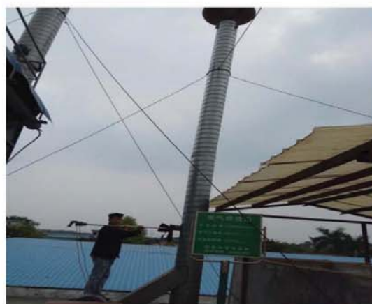
图10: FQ4-17052 热固化废气排放口 (处理后)
