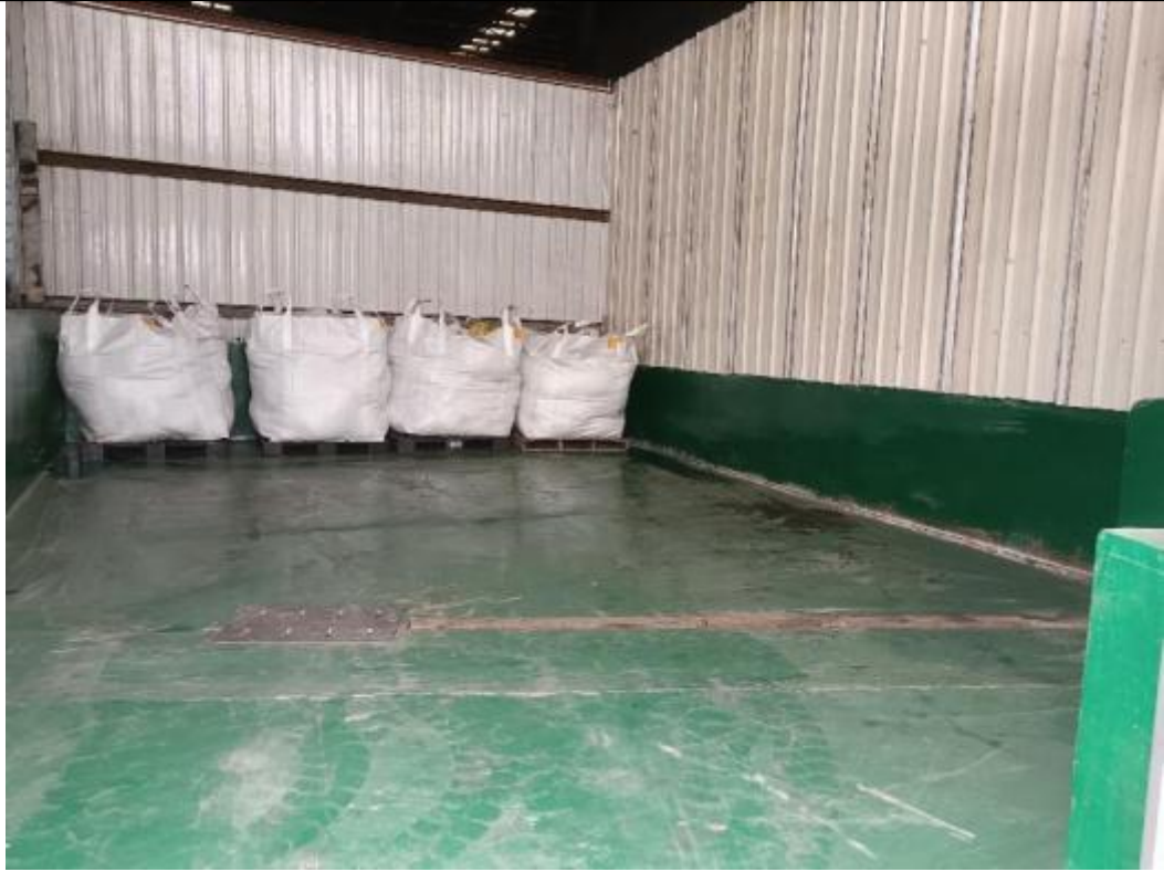
图 2.15-3 危废暂存间-地面防渗及收集沟
