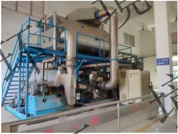
原渗滤液处理设备
